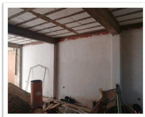
IMAGEN 3: REVOQUE DE CIELO RASO
