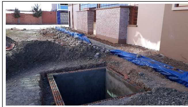
IMAGEN 1: Construcción de pozo séptico
