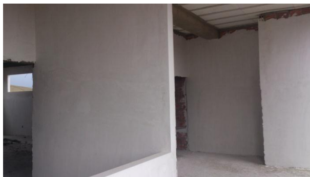
IMAGEN 3: REVOQUE INTERIOR DE YESO
