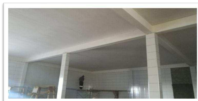
IMAGEN 3: REVOQUE DE CIELO RASO
