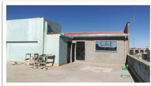
IMAGEN 1: CUB. CALAMINA Nº28 + ESTRUCTURA MET.
