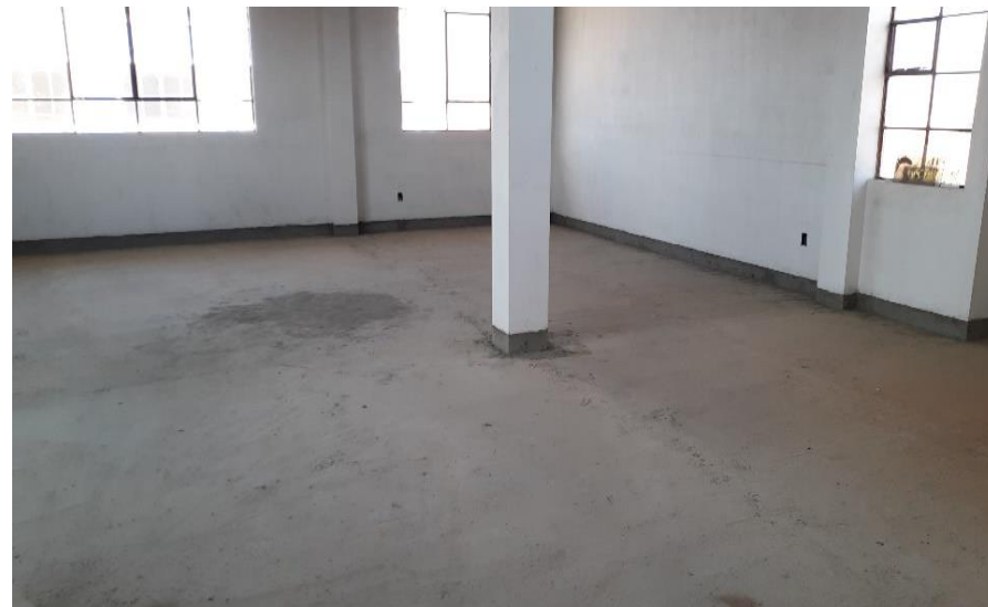
Vaciado de contrapiso en todos los ambientes, revoque con estuco en todos los ambientes Urb.
