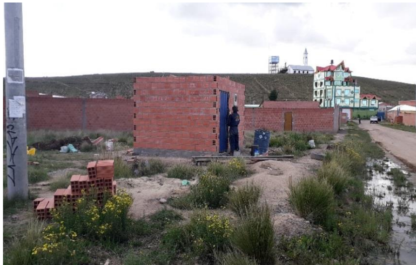
Caseta de bombeo Urb. P.D.M. DISTRITO 6
